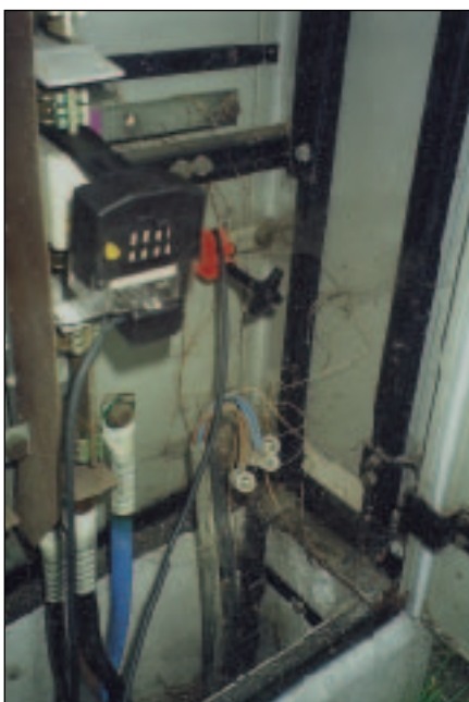
Obr. 5: Rozváděč před vyčištěním
