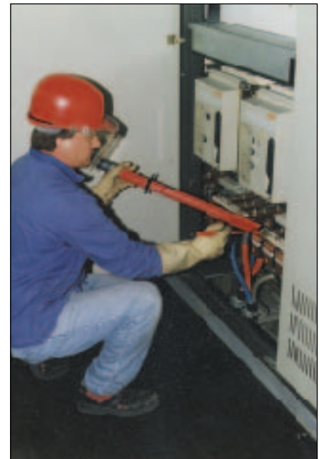
Obr. 10: Čištění zařízení pod napětím metodou „práce na vzdálenost“, příp. metodou „práce s izolačními rukavicemi“
