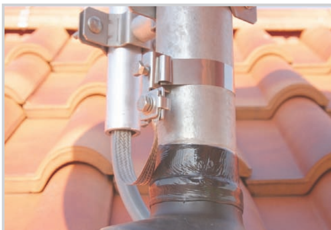
Obr. 3: Detail připojení podpůrné trubky na uzemněný anténní stožár
